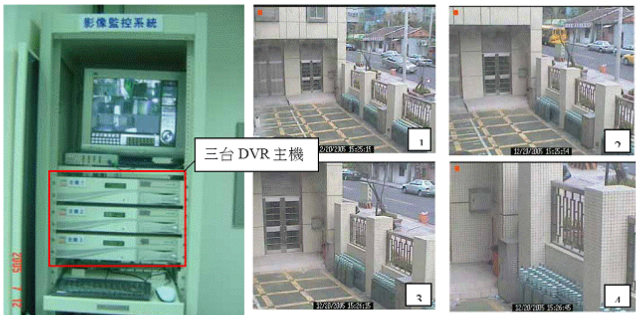
圖1、天母變電所影像監控系統
